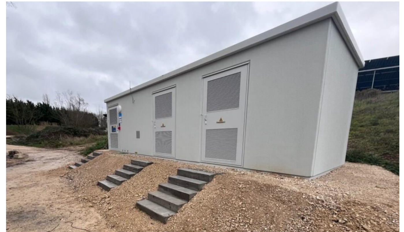
Photo 1 : Illustration d'un poste de livraison avec le RAL 7035 (Source : ENGIE Green)
