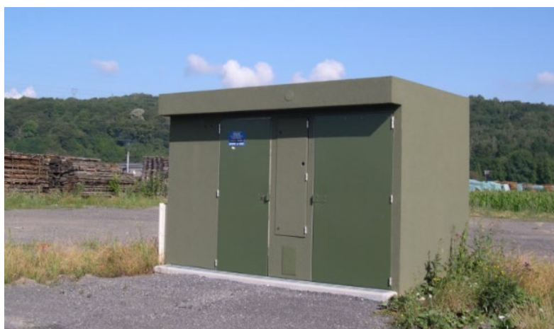
POSTE DE LIVRAISON/TRANSFORMATION
