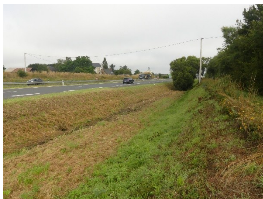
Noue de gestion des eaux pluviales bordant la RD775
