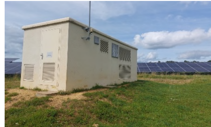
Fig.82 Exemple de poste électrique
