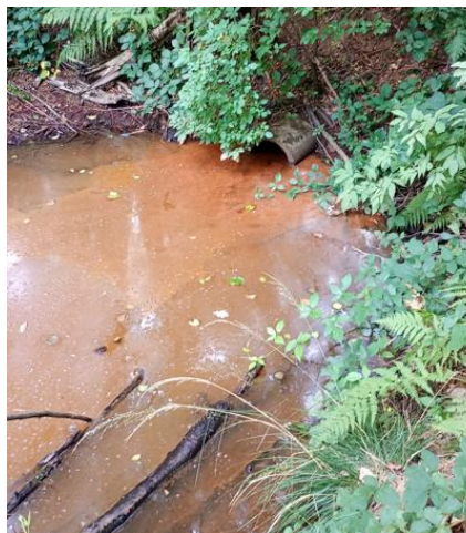
Exutoire moine étang bas (conduite béton Ø 300 mm) et bassin de décantation
