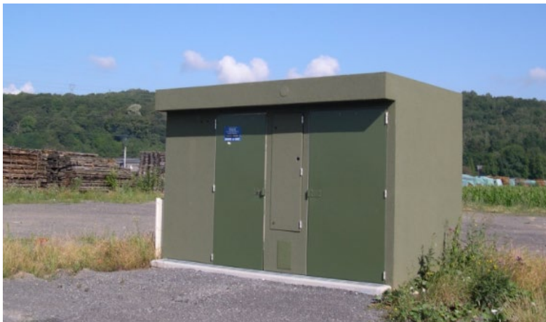
Figure 12 : Exemple de poste de livraison/transformation – Source : Melvan
