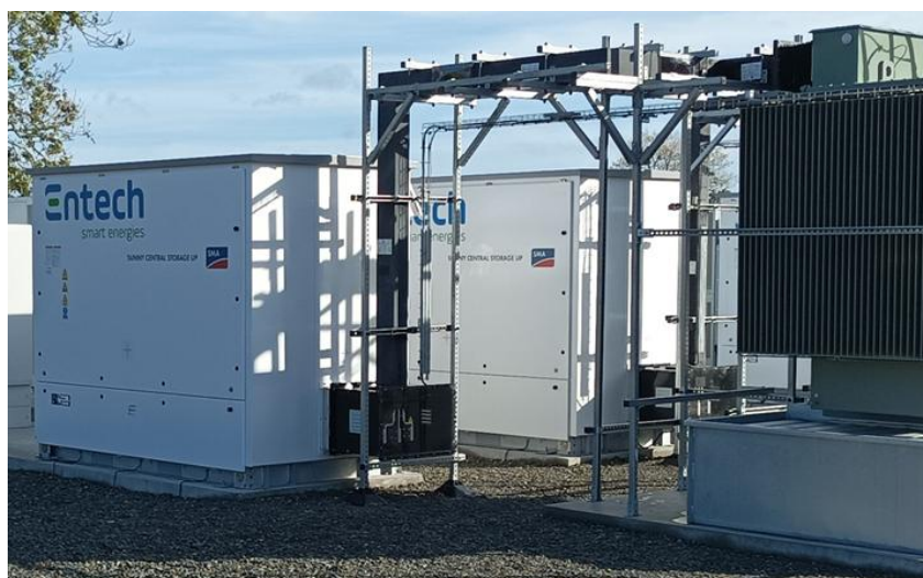
Photo 2 : Illustration indicative d'un « jeu de barres » entre PCS et un transformateur de puissance BT/HTA (Source : TSE)
