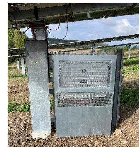
Figure 14: onduleurs string (source TSE)
