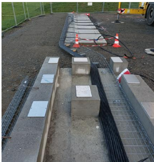
Photo 1 : Photographie indicative de chemins de câbles pour le dispositif batterie (Source : TSE)
