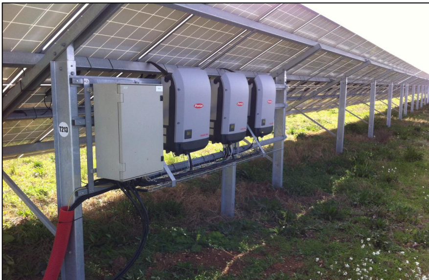
Photo 3 : Exemple d'onduleurs strings fixés à l'arrière des tables de modules
