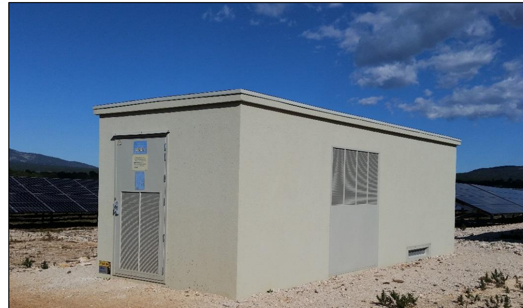
Photo 2 : Exemple de poste de transformation
