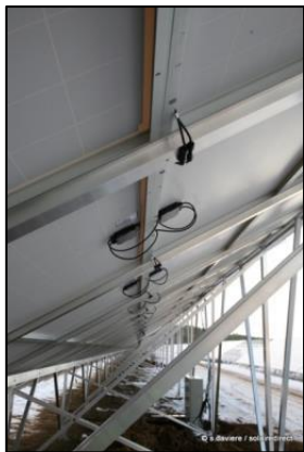
Photo 5 – Câblage sous les modules
