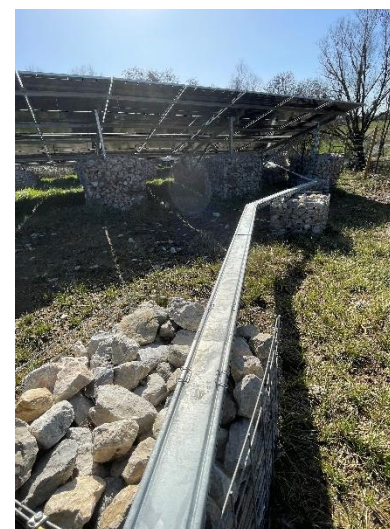
Chemin de câble aérien (St Cergues – 74)
