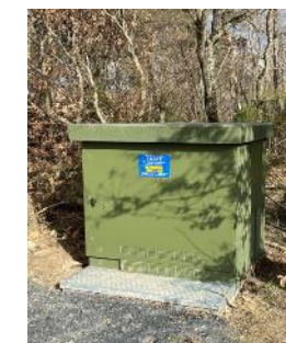
Nouveau poste de distribution publique HTA/BT (Enedis)
