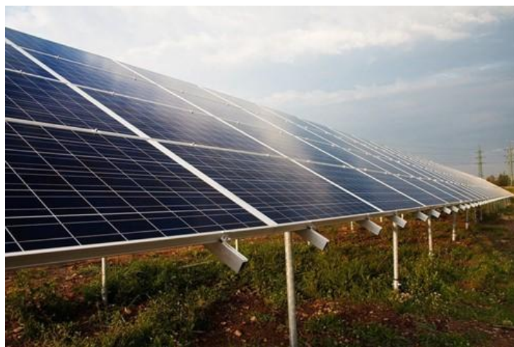
Illustration 4 : Panneaux photovoltaïques (Source : omeo.com)
