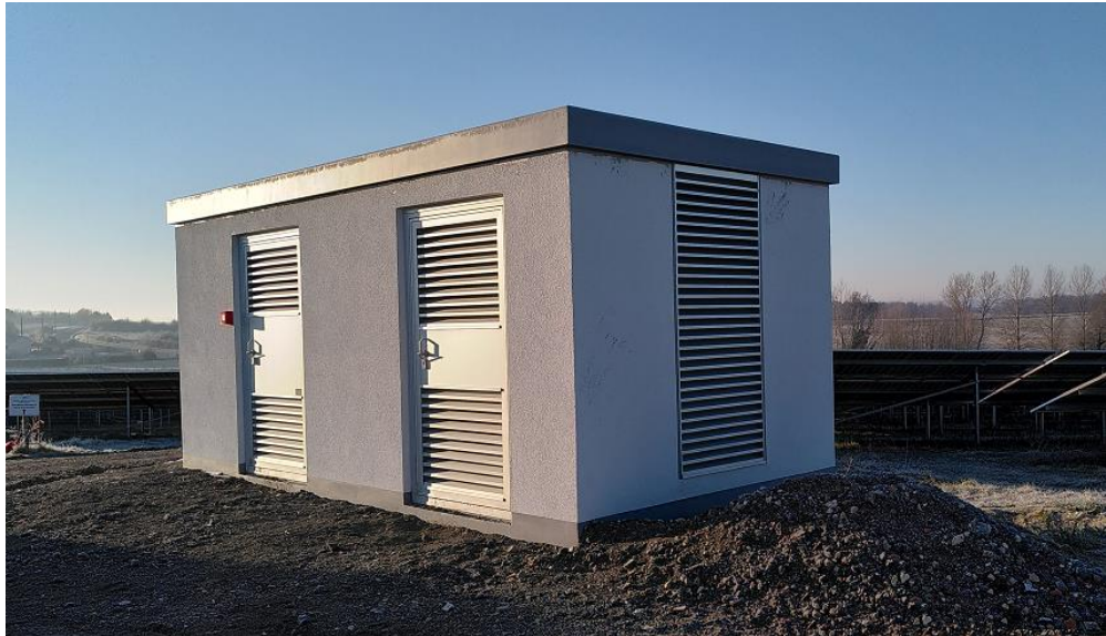
Figure 7 - Poste de transformation remblayé
