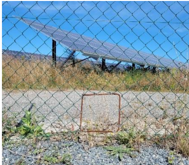
Figure 11 - Passage faune à Exideuil (16)
