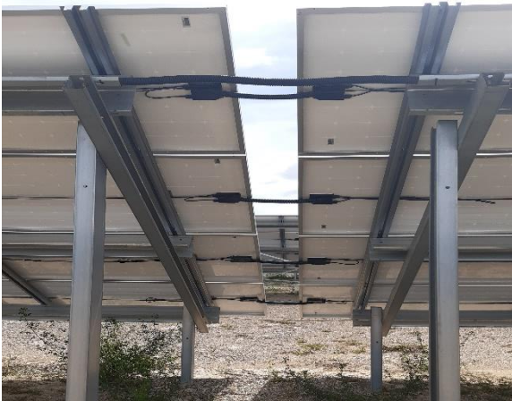
Figure 5 - Câblage sous modules
