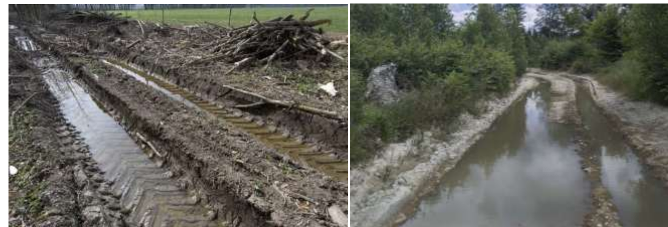
Figure 17 : Exemple d'ornières et dépressions à éviter
