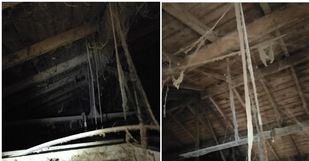
Combles désaffectés avec couche d'isolation dégradée
