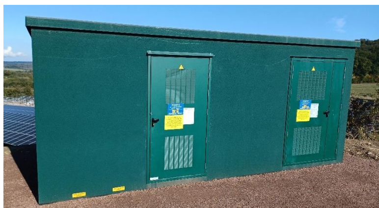
Figure 5 : Exemple de poste de livraison
