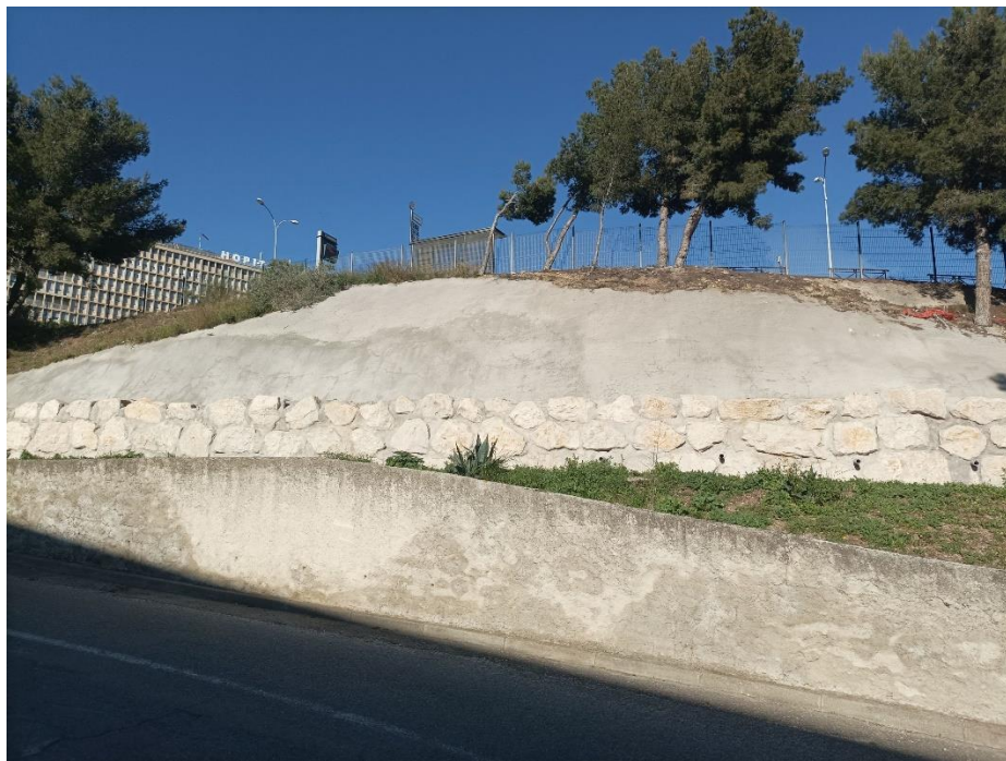
Figure 20 : Enrochement identifié dans le PLUi pour les mouvements de terrain (source : Inddigo, 2025)
