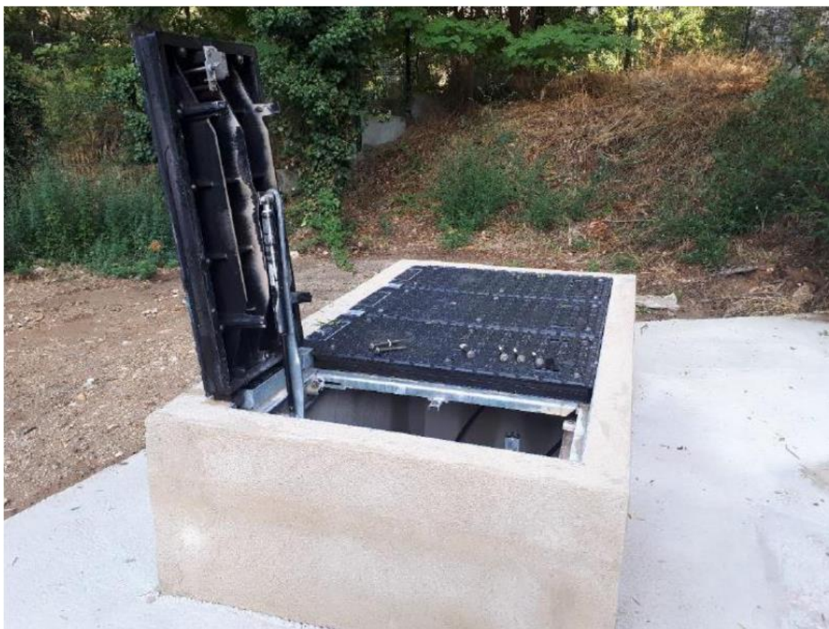
Protection du forage F4 contre les risques de contamination en cas de débordement de l'Huveaume (photo ANTEA).
