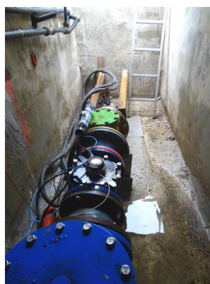
Les forages sont abrités dans une chambre bien protégée des eaux de ruissellement
