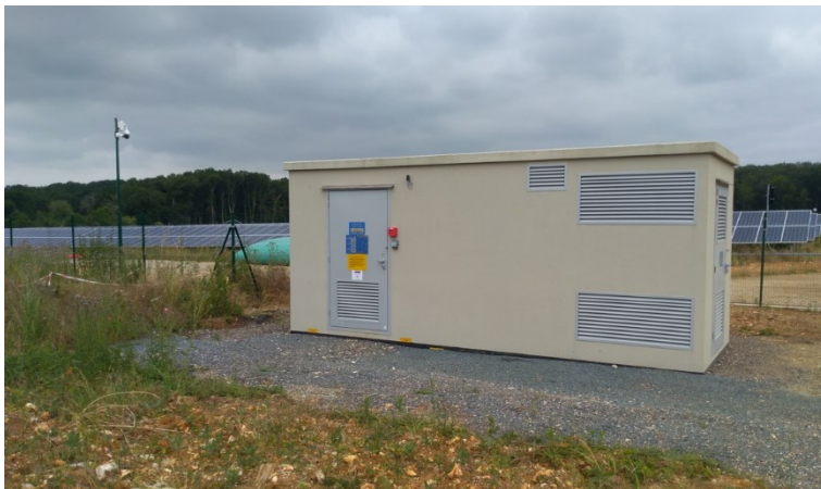
Figure 3 – Exemple d'un poste de Transformation/livraison en béton préfabriqué (source : SOG SOLAR)
