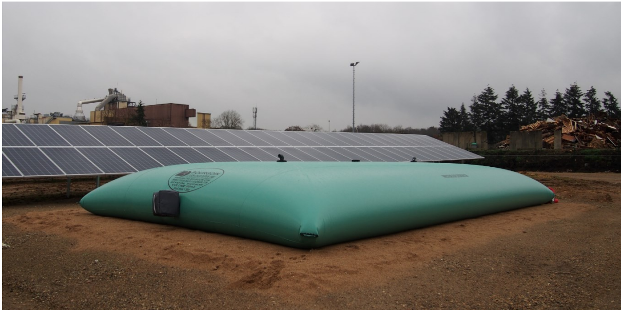
Figure 4 - Réserve incendie souple 60 m 3 (Source : SOG SOLAR)
