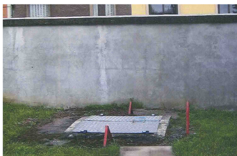
Figure 35 : Bâtiment 0048 – chambre à vanne
