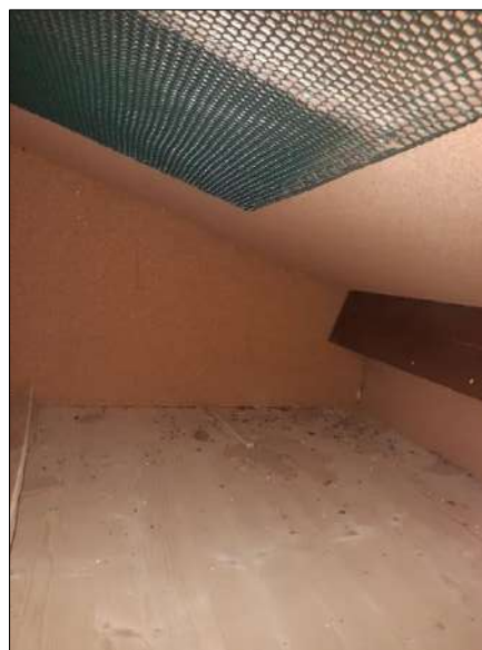
Combles avec grillage et présence de guanos
