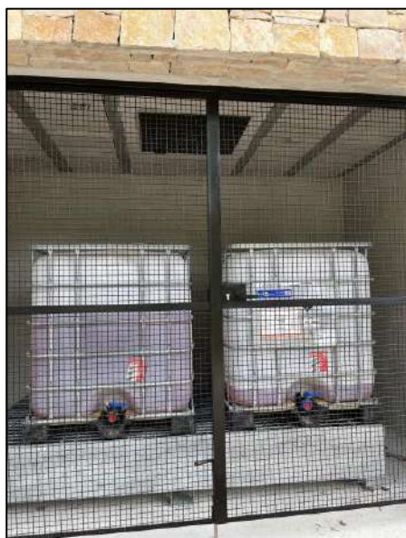
Extérieur du local acide
