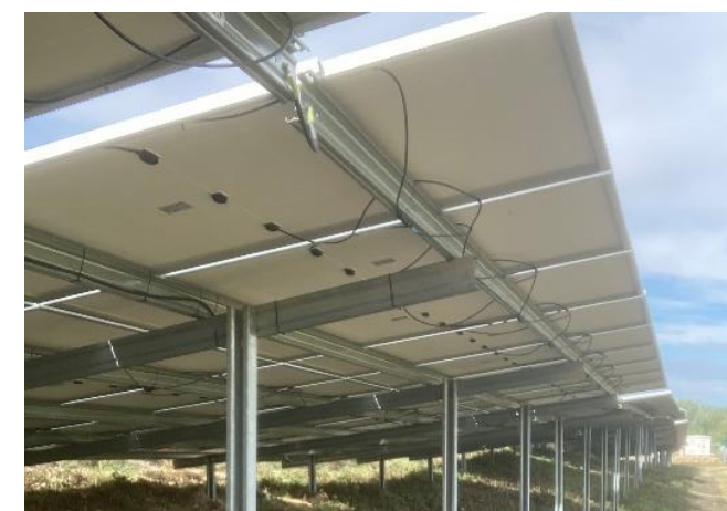
Figure 8 : Câbles reliés sous les modules (source : Sunti)
