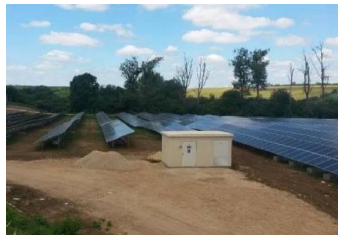
Figure 10 : Exemple de poste de transformation (source : Sunti)
