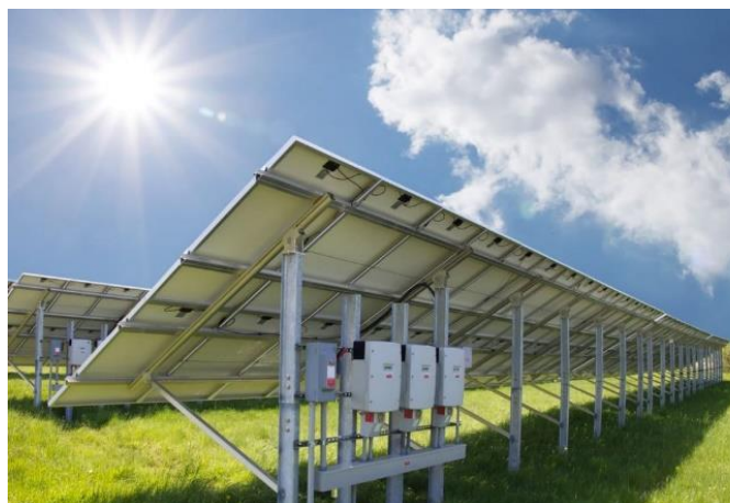
Figure 9 : Exemple d'onduleurs décentralisés (source : Sunti)
