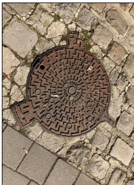
Figure 7 : Regard avec tampon collé à remplacer
