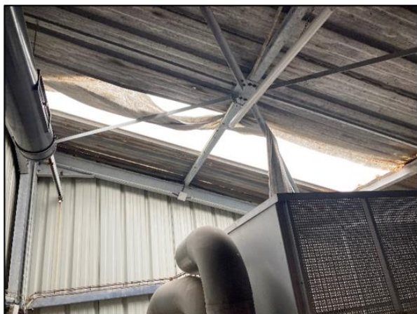
Partie de toiture arrachée
