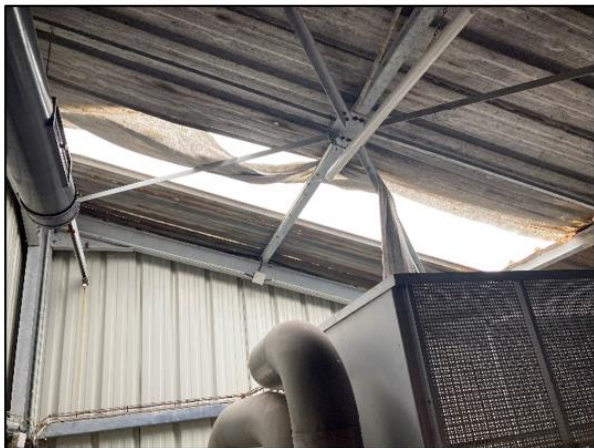
Partie de toiture arrachée
