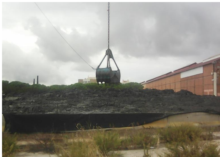
Figure 4 : Aire de stockage tampon – Dragage darses des CNIM
