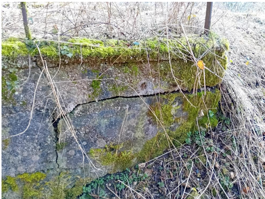
Fracture du mur tympan. Béton faiblement ou non armé, avec ségrégation.
