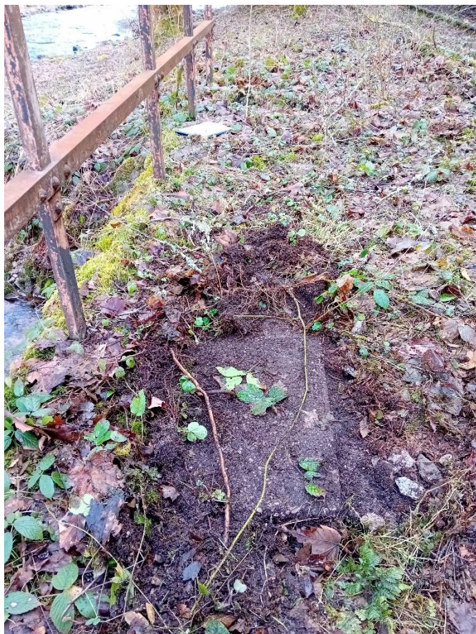
Tablier (vue sur caniveau technique) recouvert de végétation.
