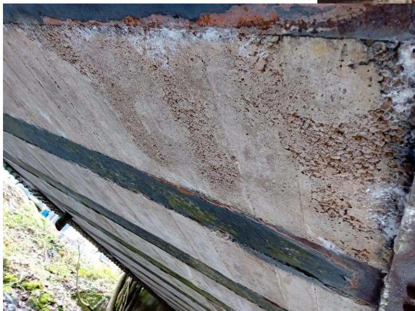
Zone de tablier avec nid de cailloux.
