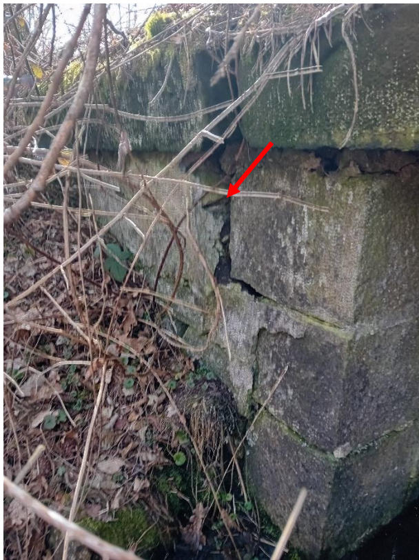
Basculement et déversement du mur en retour.
