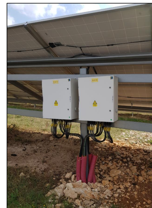
Figure 14 : Onduleur string (source : TSE)
