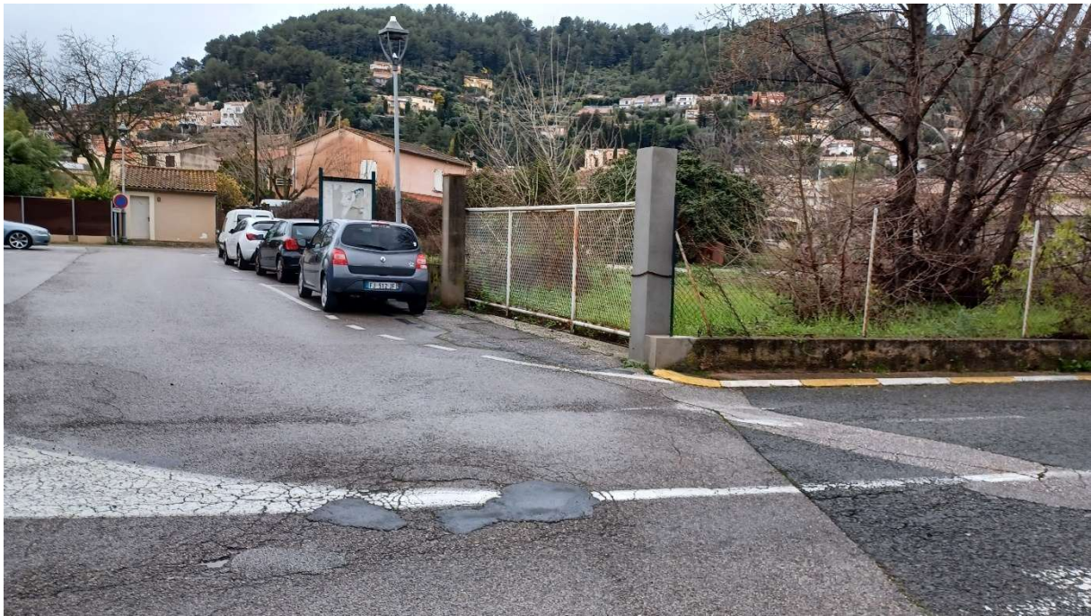
Photo 4 : Zone privative non entretenue (CITADIA, Mars 2025)
