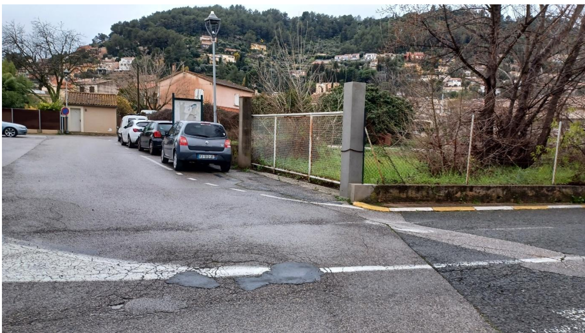
Photo 4 : Zone privative non entretenue (CITADIA, Mars 2025)
