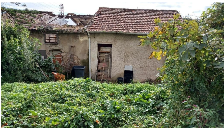
Photo 6 : Maison abandonnées avec fissures sur façade et dans le toit (Citadia)
