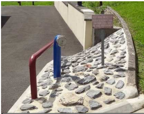
Point d'aspiration au niveau de la salle polyvalente
