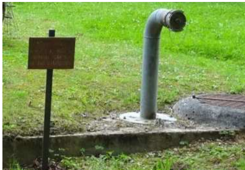
Point d'aspiration rue du Moulin
