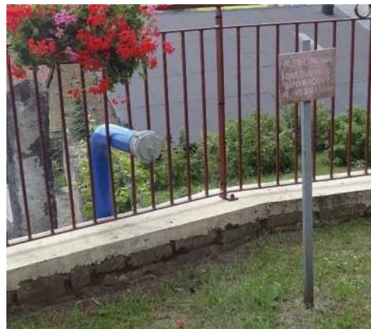
Point d'aspiration au niveau de l'église
