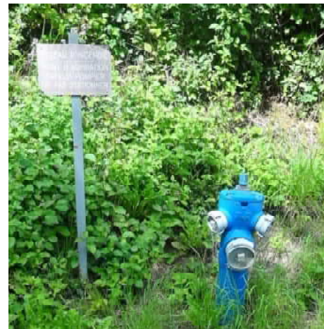
Borne au niveau du réservoir
