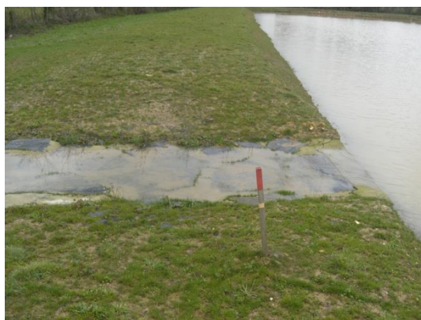
Exemple de surverse à ciel ouvert
