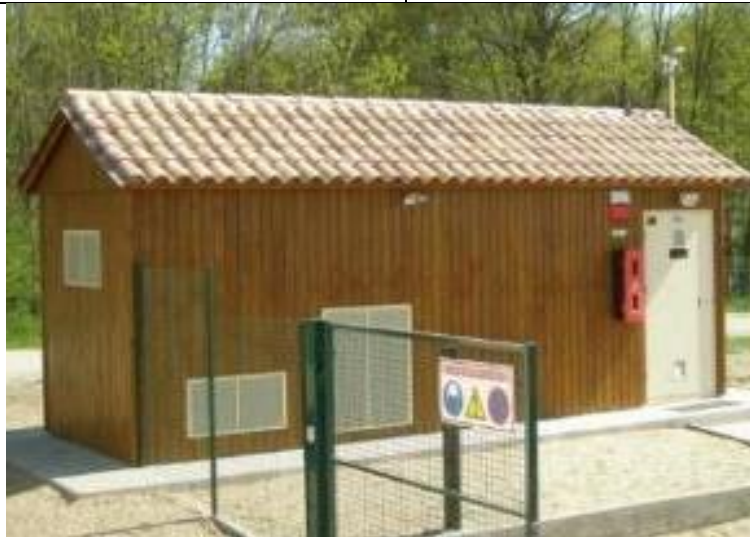
Poste de livraison et de transformation
