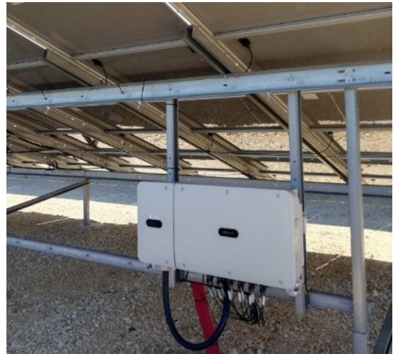
Onduleurs décentralisés (string)
