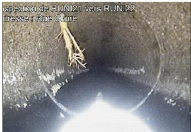
Présence d'une grosse racine isolée
