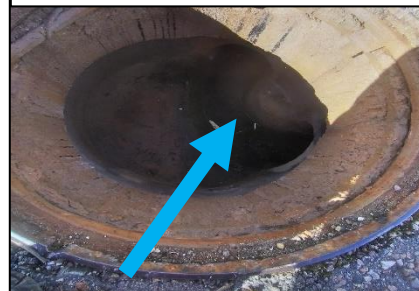
Regard EP (rejet vers fossé)
