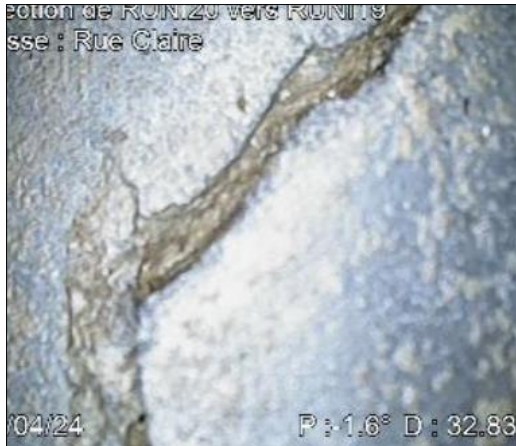
Fissure circumférentielle ouverte
