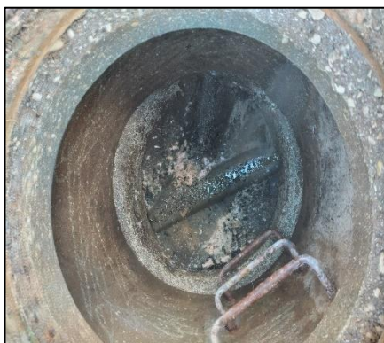
Stagnation des effluents au fond du regard 10 (Rue de la Potesse)
