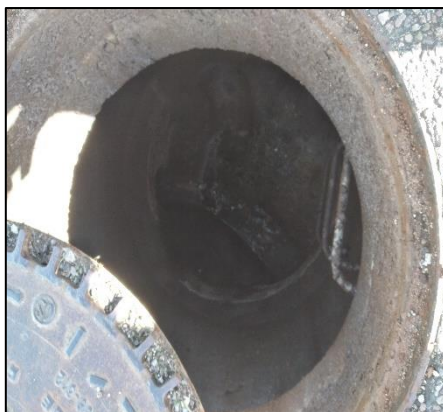
Dépôt + défaut cunette R5 EU (rue de la Potesse)
