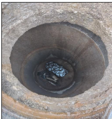
Canalisation endommagée continue R17 Rue Verdun
