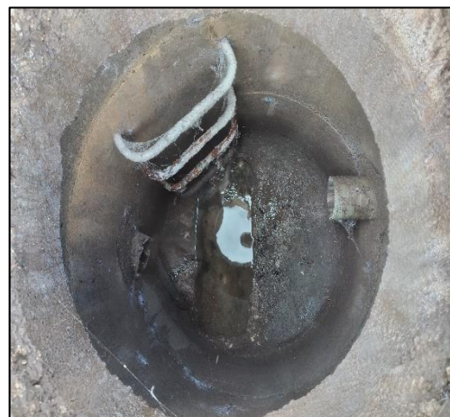
Défaut de cunette R 22 (Rue Claire)
