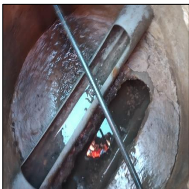
Fissure et dépôt du gravier au fond du regard 5 (rue de la Fontaine)
