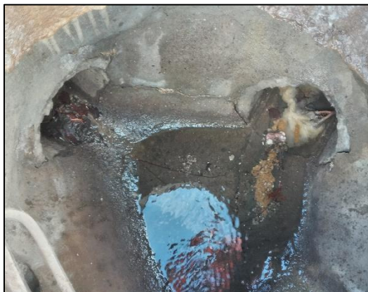
Fissure regard R24 Rue Verdun
