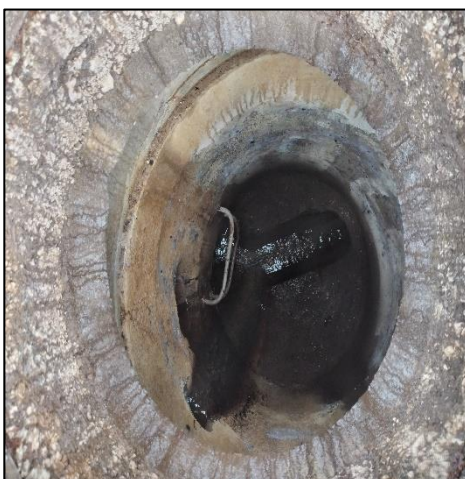
Ecoulement eaux claires continu R 20 (Rue Claire)
