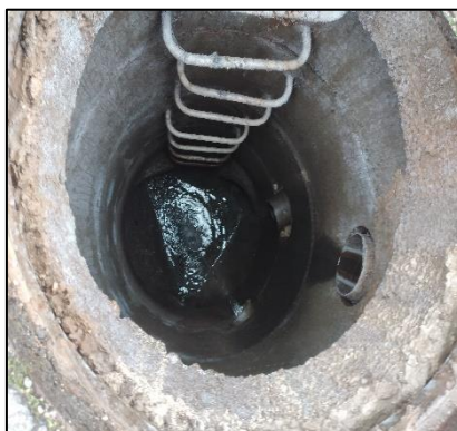
Ecoulement eaux claires continu R18 intersection rue claire et rue Verdun
