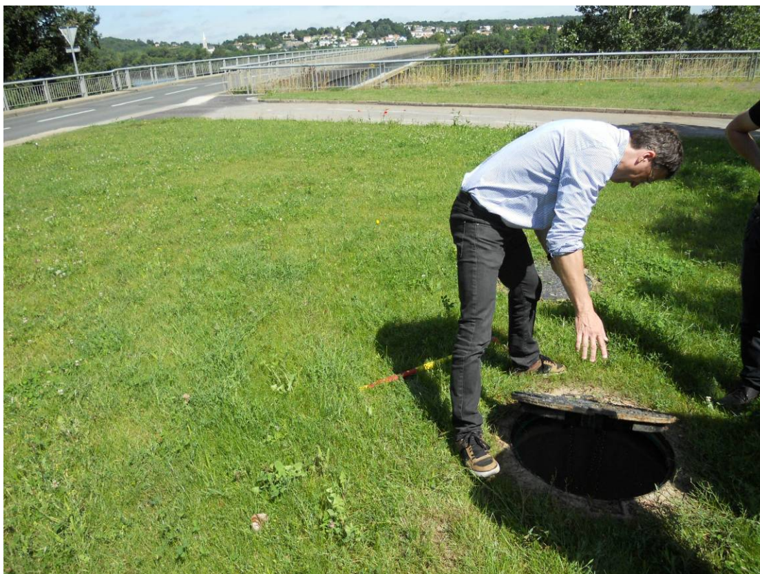
Bassin n° 2 - Regard d'accès au clapet de fermeture de la sortie du bassin
