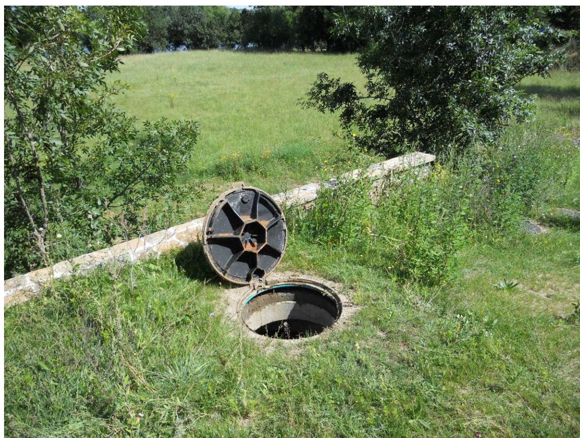
Bassin n° 1 - Regard d'accès au clapet de fermeture de la sortie du bassin
