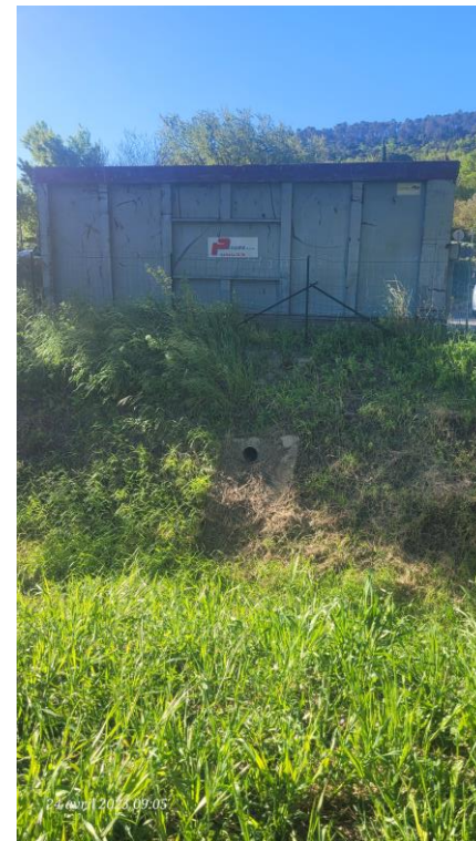
Rejet depuis l'ouvrage de prétraitement dans le bassin de rétention
