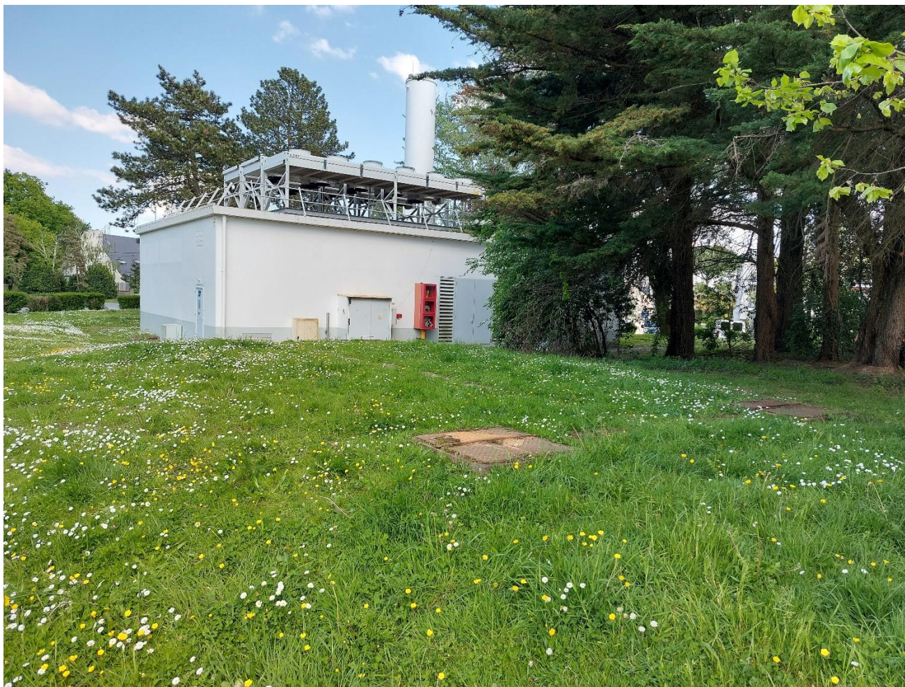
Photo 10 : emplacement de la pompe à chaleur de la chaufferie de La Bouletterie – vue proche
