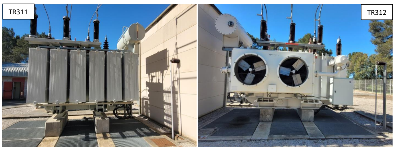
Illustration 9 : Photographies des transformateurs du poste source de Signes
