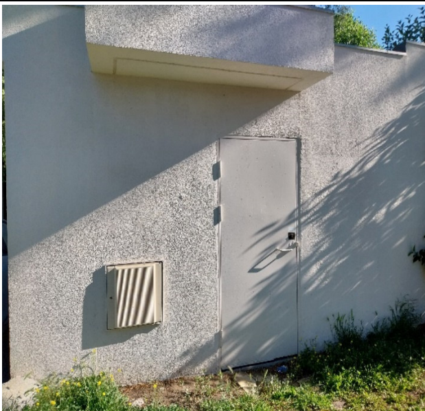
Photographie 5 : Transformateur au Sud du site
