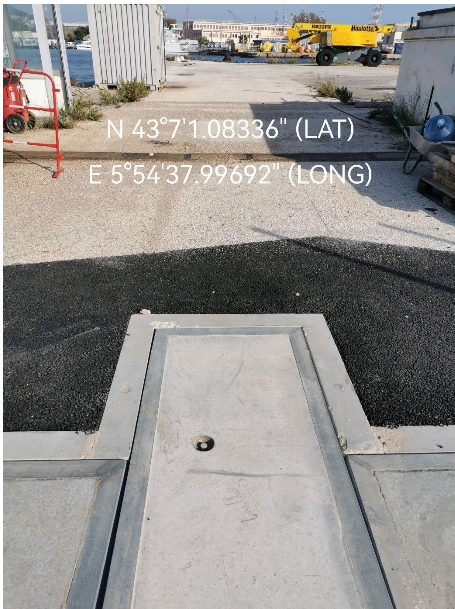
Photo 1 : Départ de la canalisation « Quai des pétroliers »
