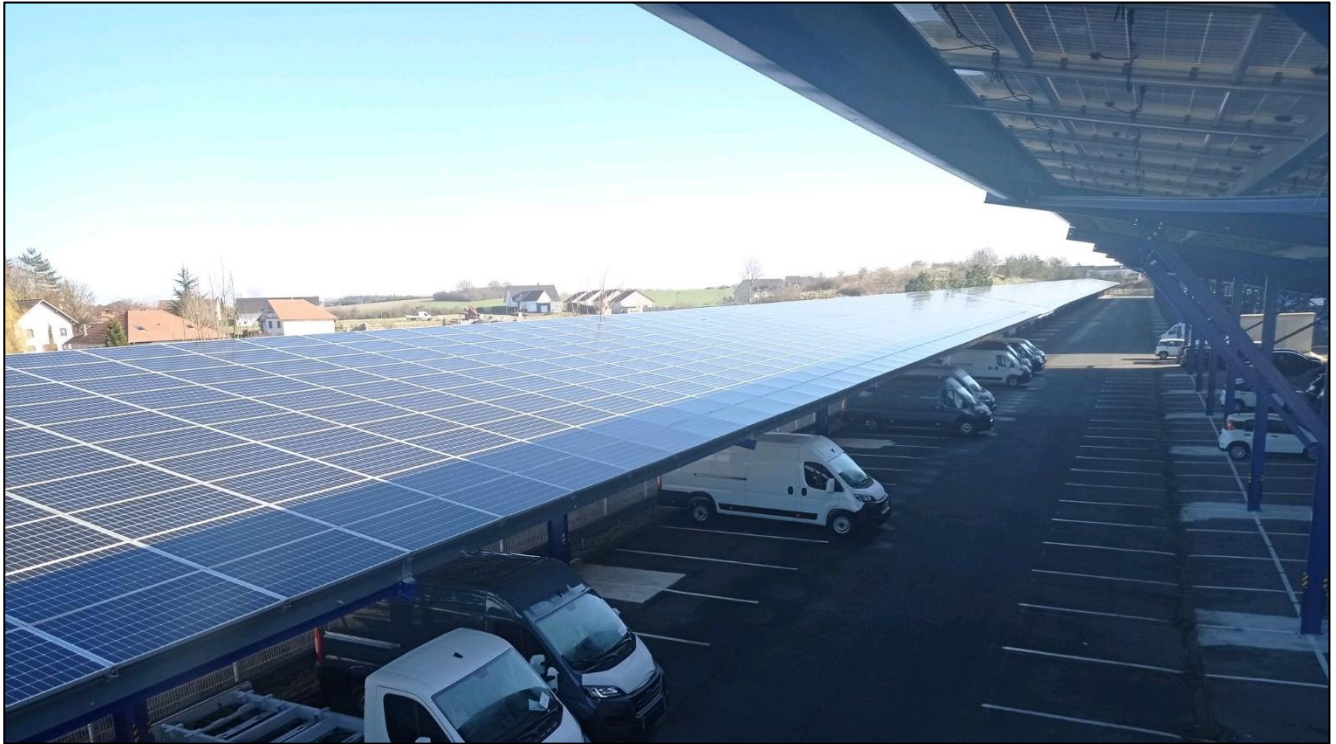
Exemple de centrale photovoltaïque en ombrières
